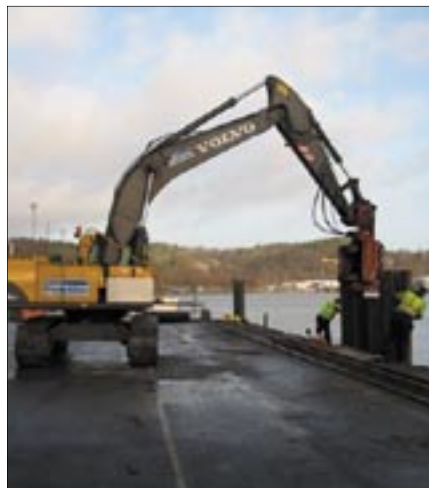
Bilden visar anläggande av en liknande skyddspont som den som kommer att användas i EKA-projektet.
