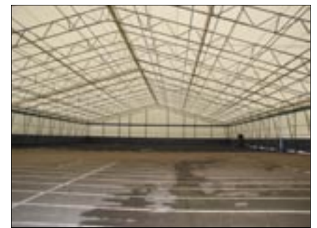
Tältet som visas på bilden ovan uppförs över cellhallsbyggnaden innan rivningen av de förorenade delarna av byggnaden påbörjas.
